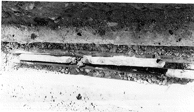
Fig. 17. Hvis der står vand i isolationsmaterialet omkring fjernvarmerørene, vil rørene i løbet af få år være ødelagt af tæring.
